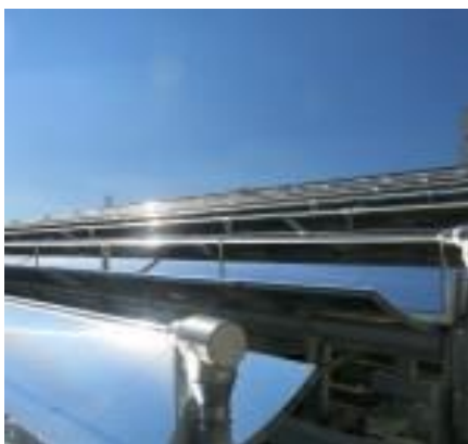
Parabolische trogspiegels, 580\text{ m}^2 , op het dak van een melkfabriek leveren warmte van 150^{\circ}\text{C}
